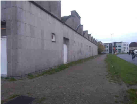
Weinig aantrekkelijke staproute (blinde saai gevel) + beperkte verlichting (naast Bau-Huis)
