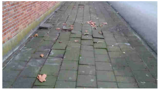
Trottoir in slechte staat (plaatselijk)
